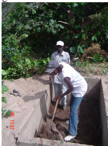
Photo : une fosse du quartier de Djiddah Thiaroye Kao
